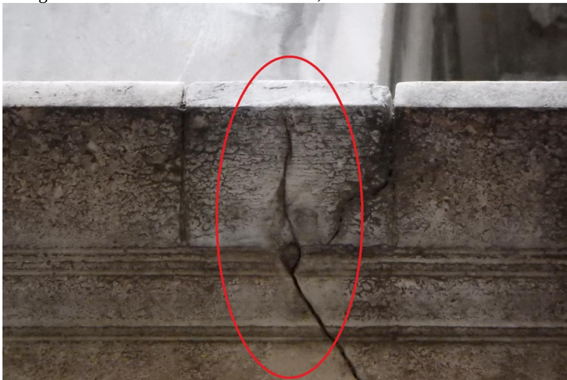
11: Dettaglio del vecchio intervento di restauro, il tassello.
