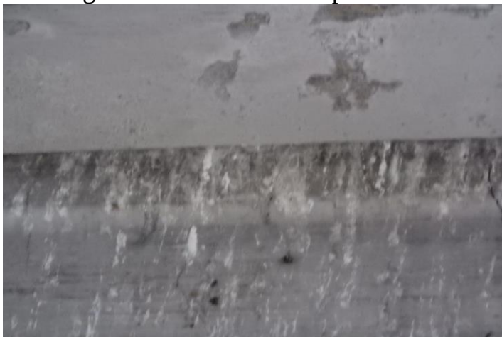
3-Dettaglio delle lesioni nell'intonaco
