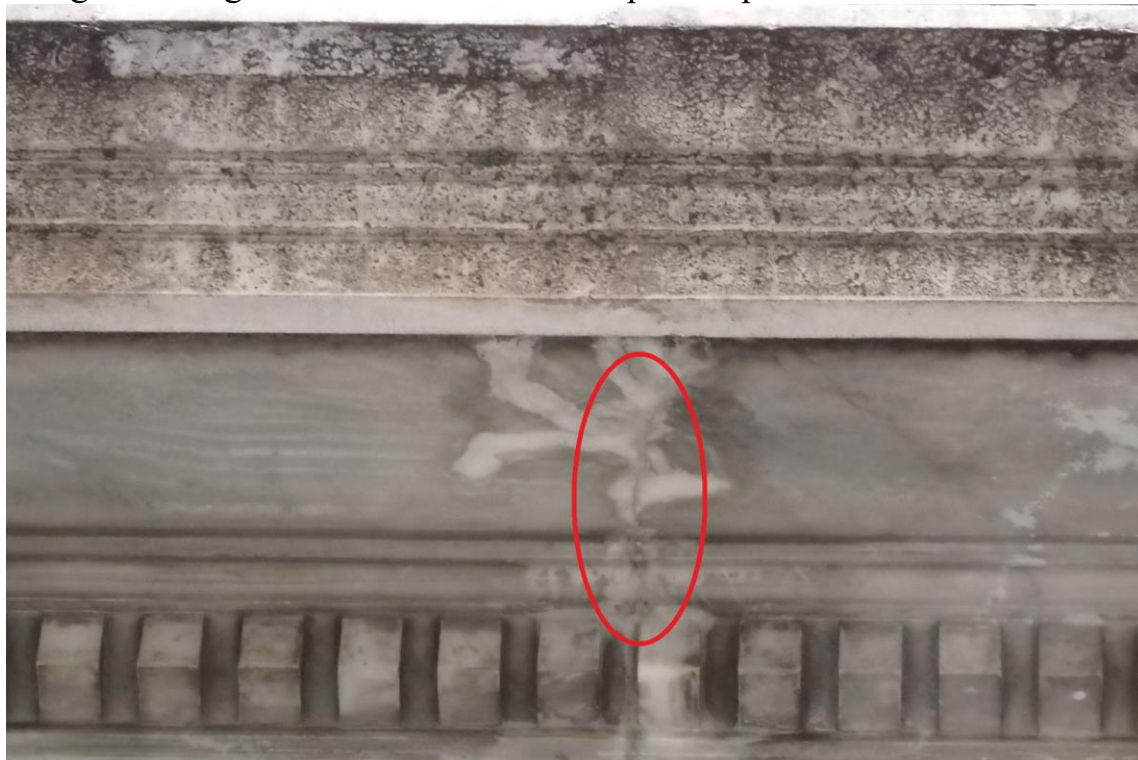
12: Dettaglio dei segni bianchi lasciati dall'acqua che passa attraverso la cornice
