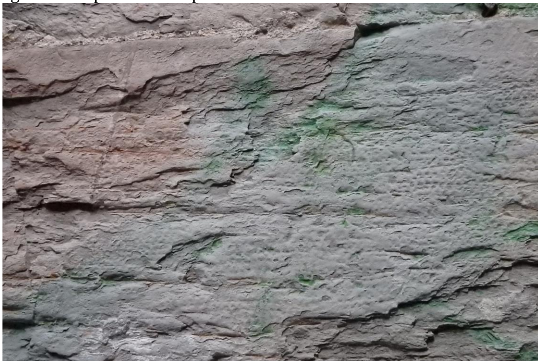
4-Dettaglio di una parte delle superfici molto deteriorata e con tracce di vernice
